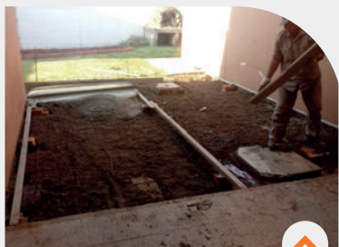
Edificio COPADI-ETI. Impermeabilización de cubierta del techo 250m 2 . Ejecución de contrapiso 20m 2 .
